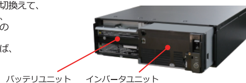
バッテリーユニット インバータユニット
